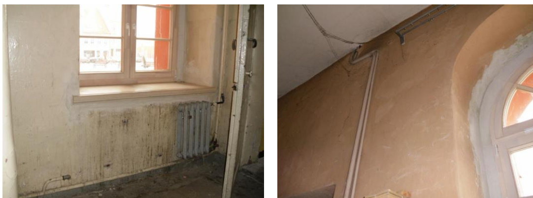
Zdjęcie 2. Pomieszczenia Ratusza wymagające rewitalizacji – stan techniczny [Źródło: Urząd Miejski w Grodkowie]
